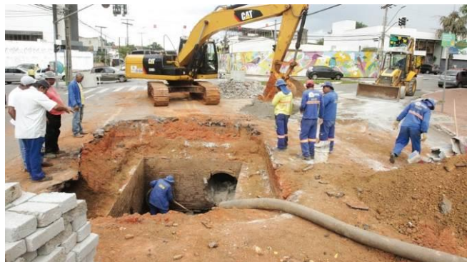
FIGURA 52 – Fotografia do jornal O Popular, de 18 de Abril de 2015, apresentando trecho da Av. 87 no trajeto do córrego Buritis cujo asfalto havia cedido e passava por obras de reparo
