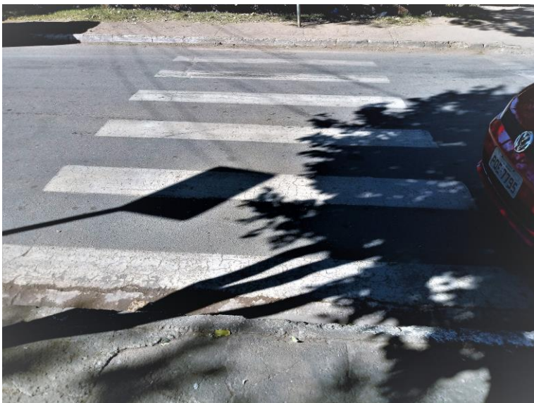
IMAGEM 05 – Faixa de pedestre sem rebaixamento de calçada. Fonte: João Gonzaga 19/06/2018.
