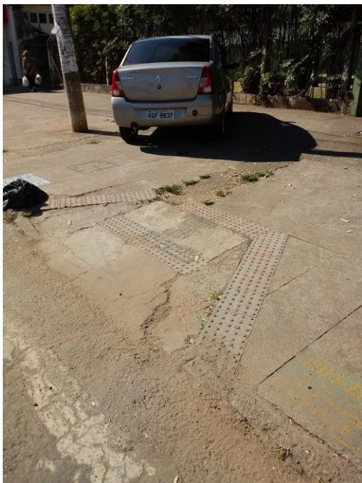
IMAGEM 24 – Rebaixo de calçada danificado. Fonte: João Gonzaga 14/08/2018.
