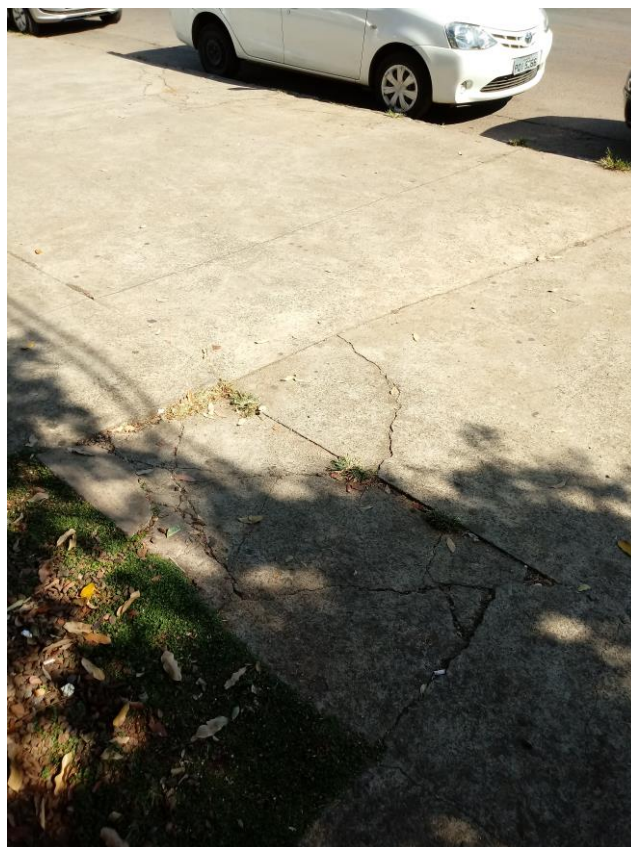
IMAGEM 23 – Calçada frontal danificado. Fonte: João Gonzaga 14/08/2018.
