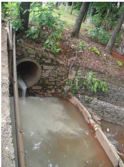
Figura 11 – Lançamento de esgoto no Córrego Vaca Brava. Fonte: Isabel Pastore, setembro de 2012.
