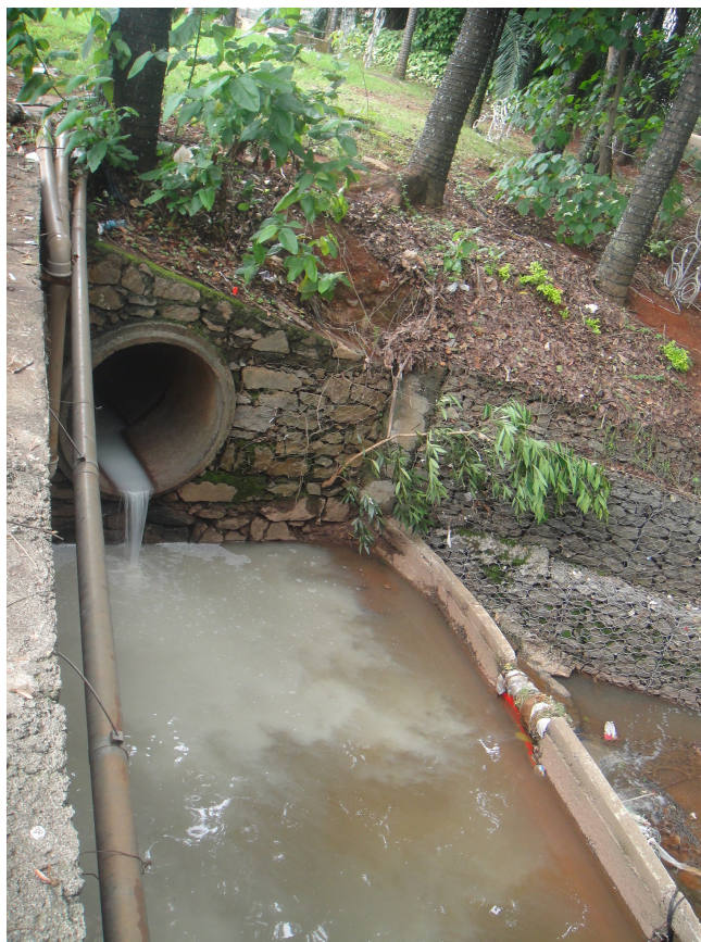
Figura 17 – Descarga de esgoto no córrego. Fonte: Isabel Pastore, setembro de 2012.
