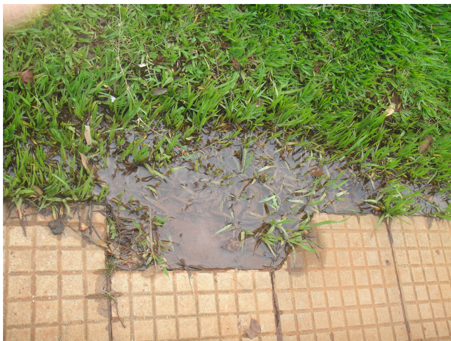
Figura 13 – Área alagada no contorno dos passeio.
