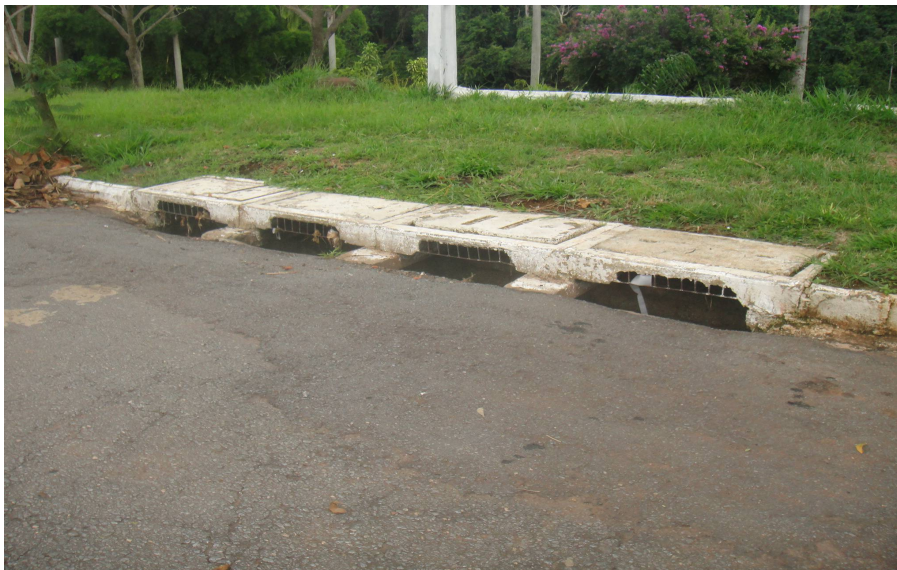
Figura 18: Bocas de lobo para coleta de água pluvial. Fonte: Isabel Pastore, janeiro de 2013.
