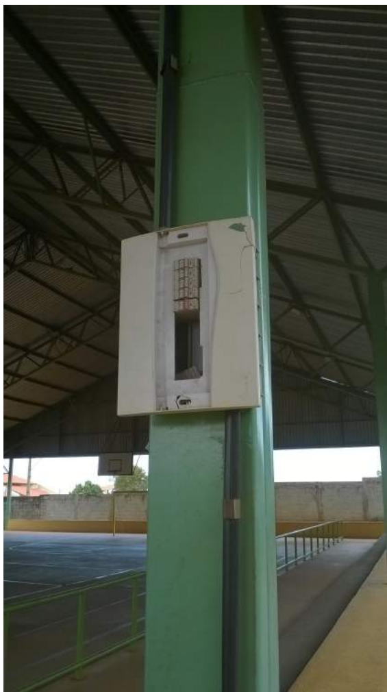
IMAGEM 025 – Disjuntor sem proteção Fonte: Analista Fiscal
