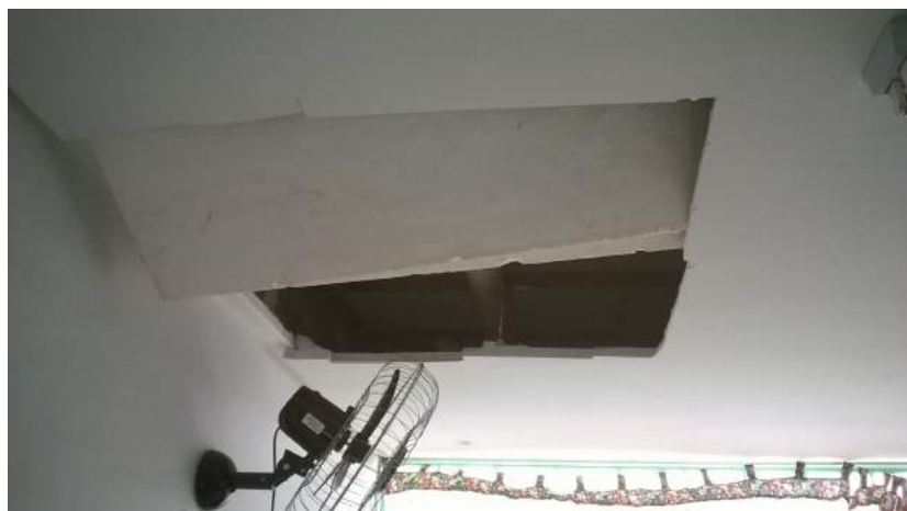
IMAGEM 024 – Gesso quebrado na sala Fonte: Analista Fiscal
