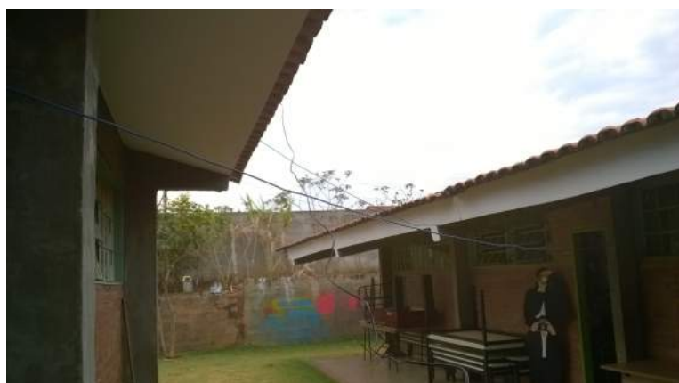
IMAGEM 019 – Fiação exposta Fonte: Analista Fiscal
