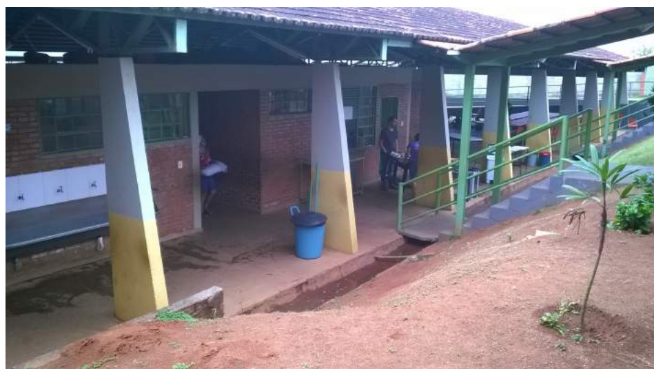
IMAGEM 021 – Talude sem proteção Fonte: Analista Fiscal
