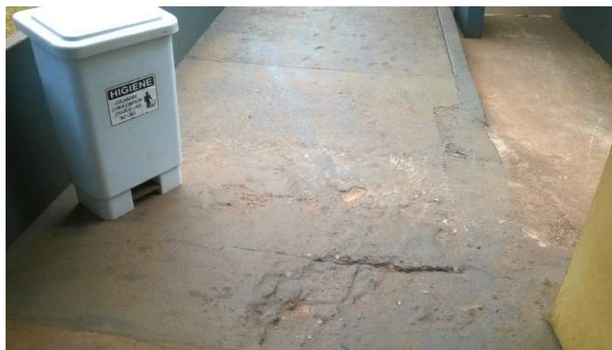
IMAGEM 011 – Piso da rampa danificado Fonte: Analista Fiscal
