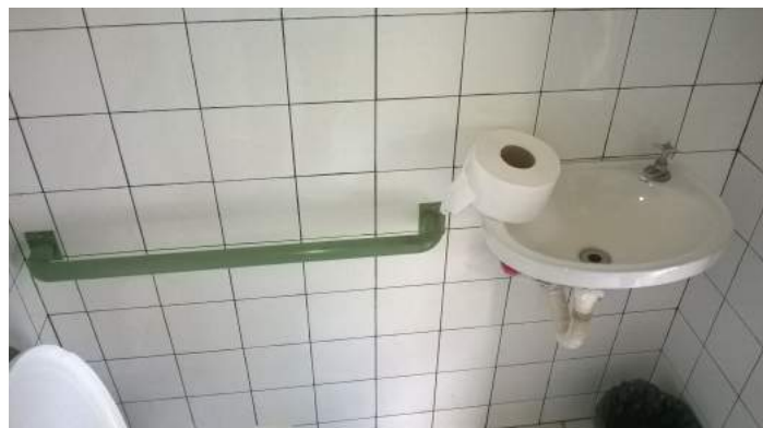
IMAGEM 05 – Lavatório do banheiro acessível Fonte: Analista Fiscal
