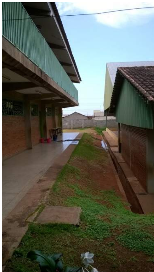
IMAGEM 020 – Talude sem proteção Fonte: Analista Fiscal
