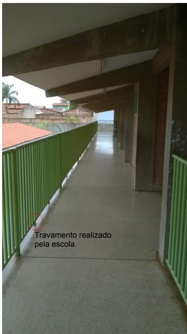
IMAGEM 022 – Guarda-corpo 2º Pavimento Fonte: Analista Fiscal
